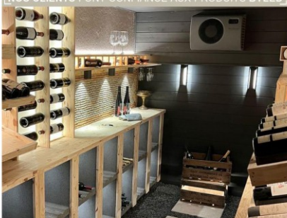
Eclairage d'une cave à vin avec les produits BYLED - Spot downlight en applique étanche 7W - STACK - Applique LED murale d'extérieur 6W - SHELF
