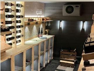
Eclairage d'une cave à vin avec les produits BYLED - Spot downlight en applique étanche 12W - STACK - Applique LED murale d'extérieur 6W - SHELF
