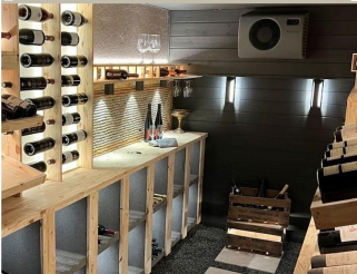
Eclairage d'une cave à vin avec les produits BYLED - Spot downlight en applique étanche 7W - STACK - Applique LED murale d'extérieur 6W - SHELF
